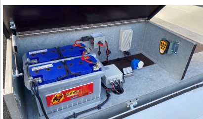
Teknikrum med batterier og lader
