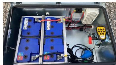
Teknikrum med batterier og lader
